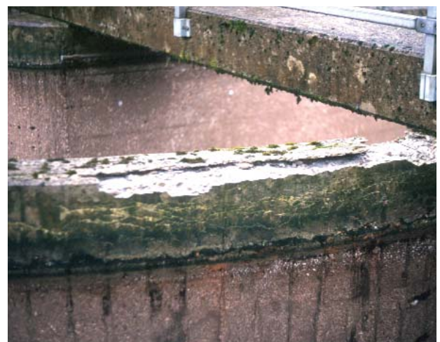
Schadensbild: lösender Angriff
